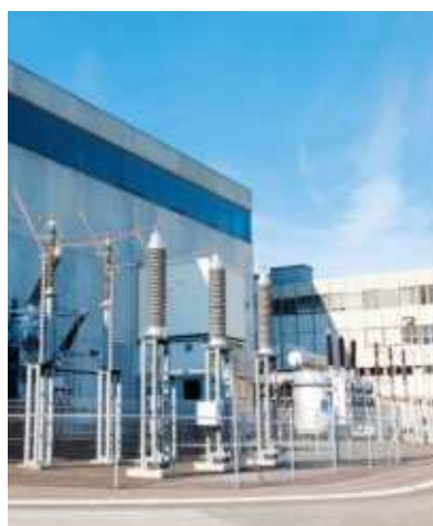
La centrale nucléaire de Mühleberg produit de l'électricité de manière fiable et sûre depuis 1972.
