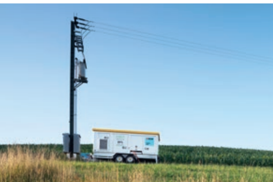
Nouveauté mondiale 2022: près de Rüderswil (BE), cette installation hybride de substitution de réseau réduit la consommation de diesel et les émissions de CO 2 .
