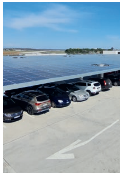
Cette installation solaire sur le toit d'un dépôt des Transports publics genevois, qui a été primée, fait partie des quelque 1 000 installations photovoltaïques réalisées en 2022 par le réseau de prestataires de BKW.
