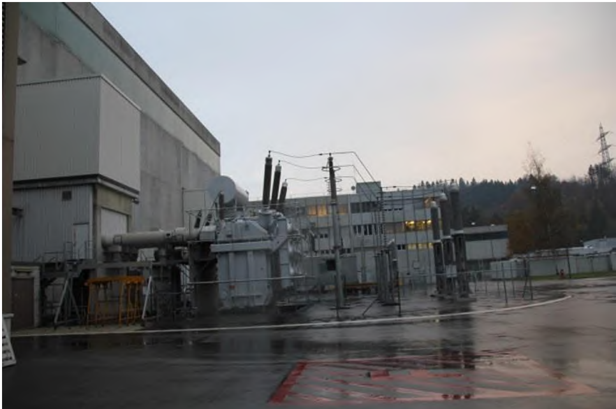
Abbildung 4.1-5: Maschinenhaus und Transformatoren
