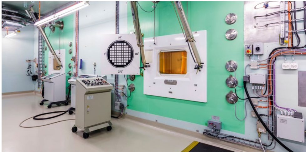
Bedienungsraum für die Heisse Zelle. Foto: Zwilag
