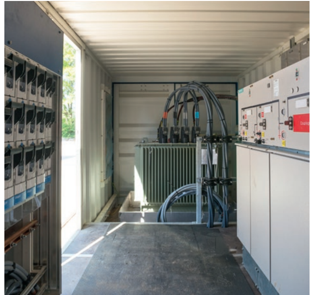
Vollausgerüstete mobile Trafostation der BKW
