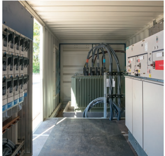
Une station transformatrice mobile tout équipée de BKW
