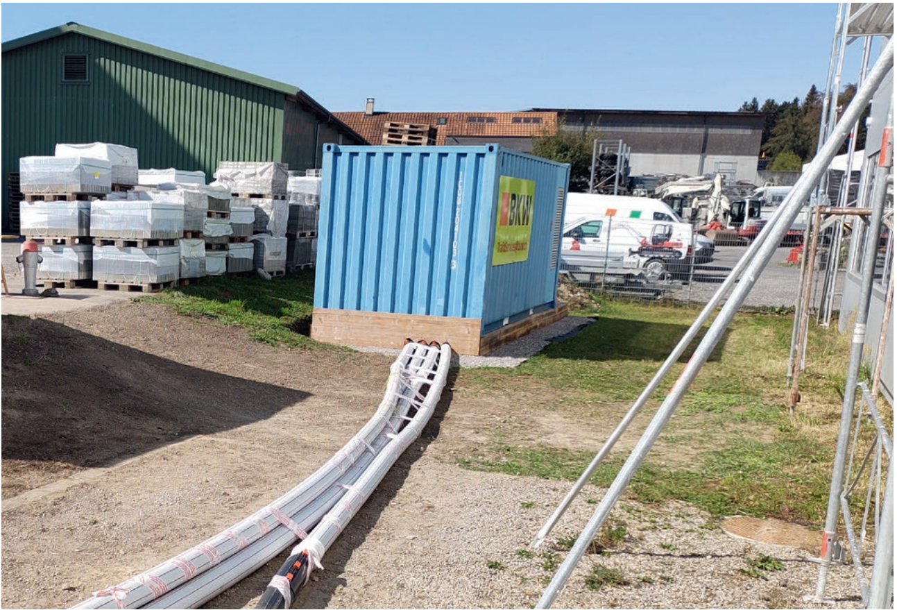
Raccordement de la station transformatrice mobile de BKW au réseau moyenne tension
