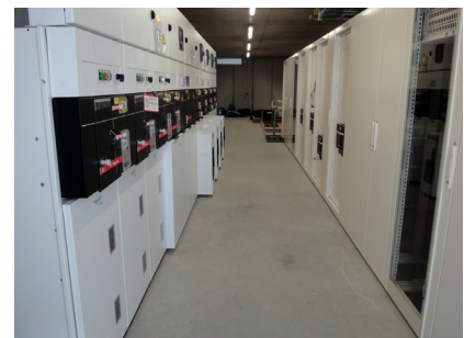
... mit vier Transformatoren à 1 000 kVA sowie der neuen Nieder- und Mittelspannungsanlage
