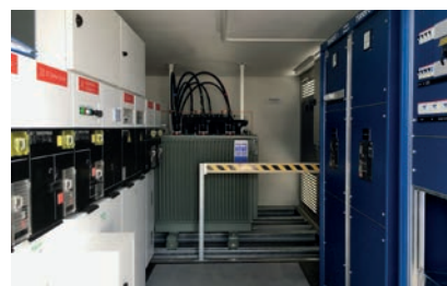
Vue de l'une des trois stations transformatrices, qui contiennent entre deux et quatre transformateurs.
