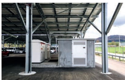
Vue sur l'ombrière, la station transformatrice et l'onduleur.
