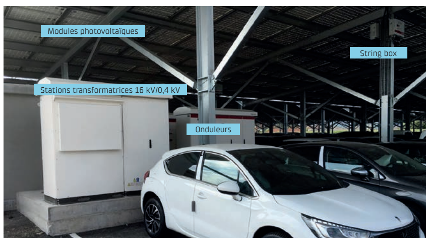
Toit solaire vu du dessous, string box, onduleur et station transformatrice en arrière-plan.
