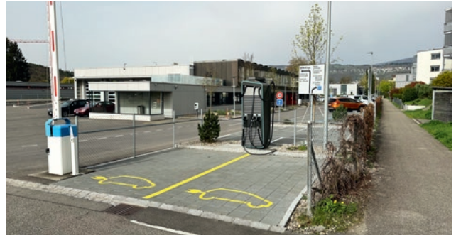
Schnellladestation für das öffentliche Laden
