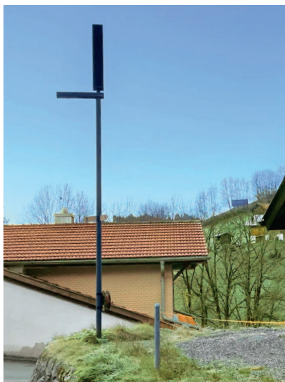
Das linke Bild zeigt die alte netzgebundene Beleuchtung, die am Niederspannungsmast hängt. Da die Freileitung verkabelt wurde, hat sich die Gemeinde insbesondere aus Kostengründen (Tiefbauarbeiten) für Solarleuchten, rechtes Bild, ausgesprochen. Im Bild die Leuchte «aron» von photinus.
