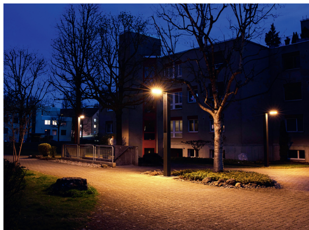
Des luminaires solaires «merkur» avec une lumière LED plus chaude (2200 Kelvin) centrée assurent un éclairage en fonction des besoins grâce à des détecteurs de mouvement.
