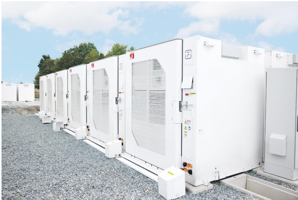
Batterien unterstützen das Ziel eines flexibleren und nachhaltigeren Energiesystems. (Symbolbild)
