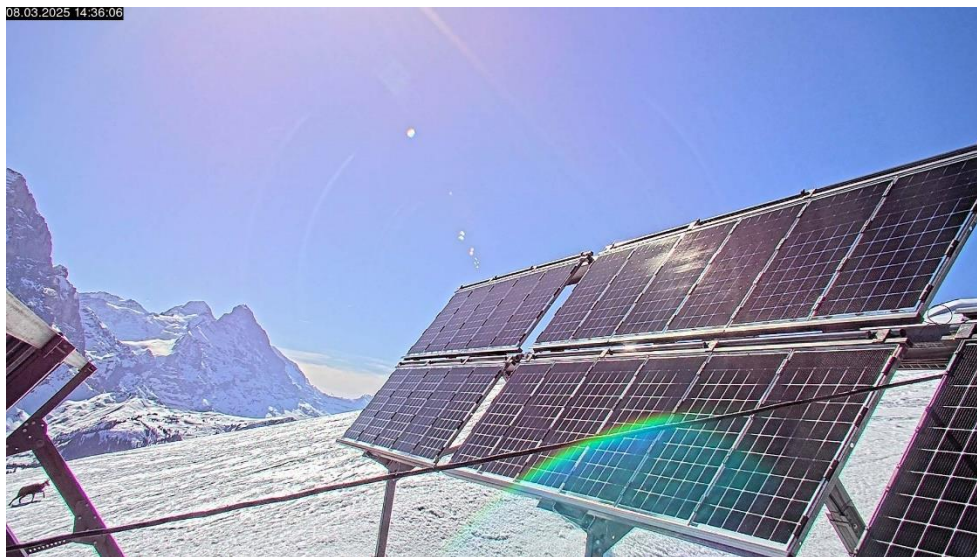
Die Testanlage Tschingel am 8. März 2025 aufgenommen durch eine vor Ort installierte Kamera.
