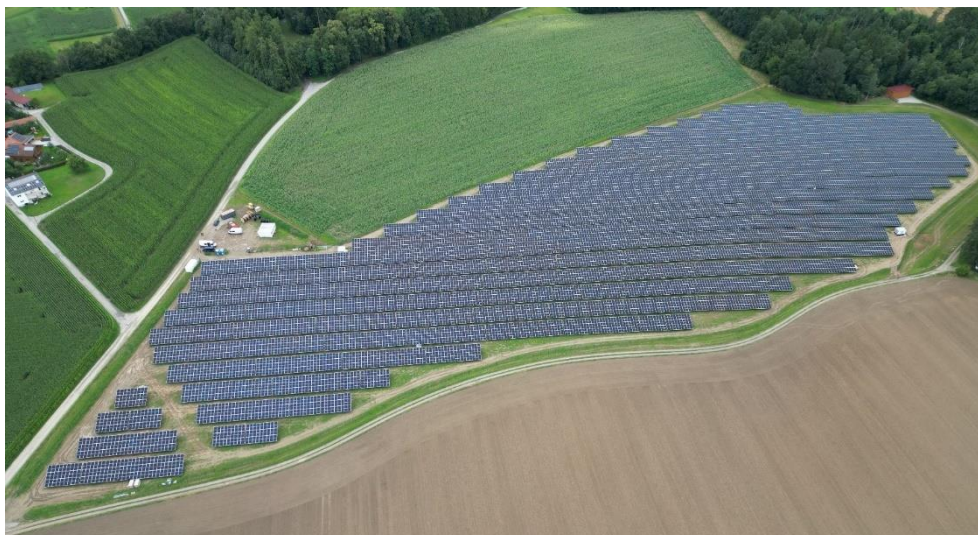
Le parc solaire de la ville de Kraiburg am Inn, situé en Bavière, sera mis en service fin 2023. Photo: MaxSolar
