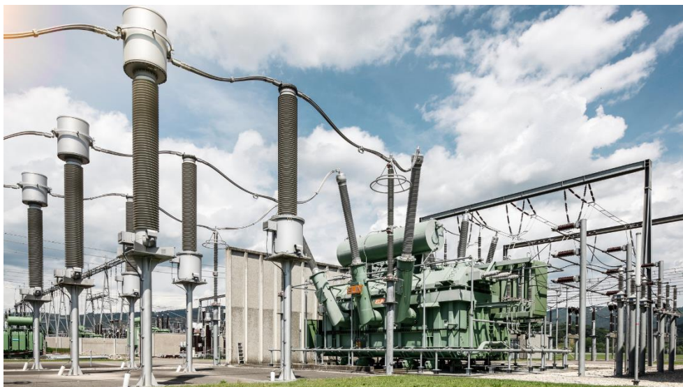
La sous-station Bassecourt.
