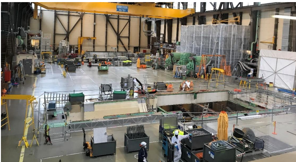
De la place a été faite dans la salle des machines pour pouvoir y traiter le matériel.
