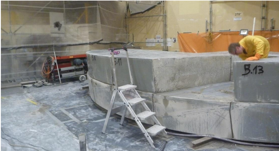
Des composants au-dessus du réacteur devenus inutiles, comme ici les dalles de blindage, ont été démontés.
