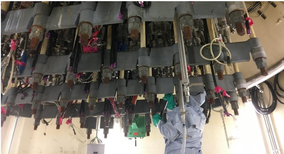
Un collaborateur de la CNM lors du démontage des organes de contrôle de la barre de commande.
