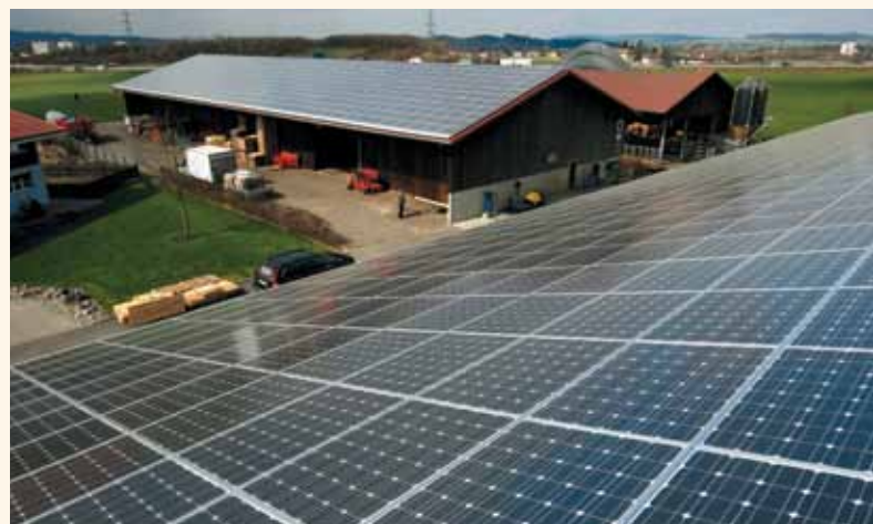
Die Biogasanlage produziert neu auch Sonnenstrom.
