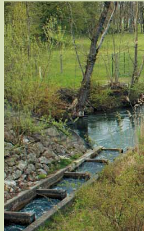
Dank Ökofonds: Fischpass beim Wasserkraftwerk Aarberg.
